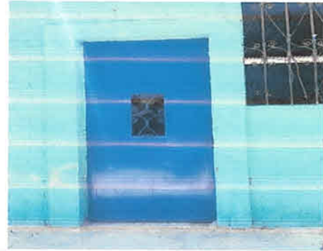
Foto 2: Puertas con chapa nueva y pintadas.
